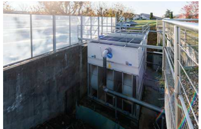
Tour aéroréfrigérantes Baltimore
